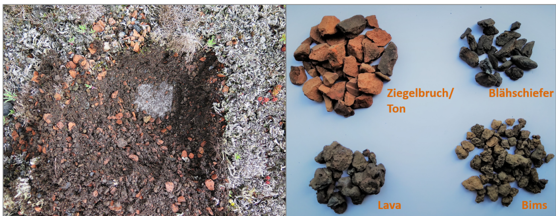
Abbildung 4: Links: Substratschicht der Extensivbegrünung auf dem Audimax. Zu sehen ist die Grobkörnigkeit und geringe Mächtigkeit des Substrates sowie das darunter anschließende Filtervlies. Rechts: Bestandteile des Skelettanteils.
